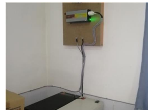
CHRD Vatomandry – Installation solaire (régulateur de charge, onduleur et batterie)
