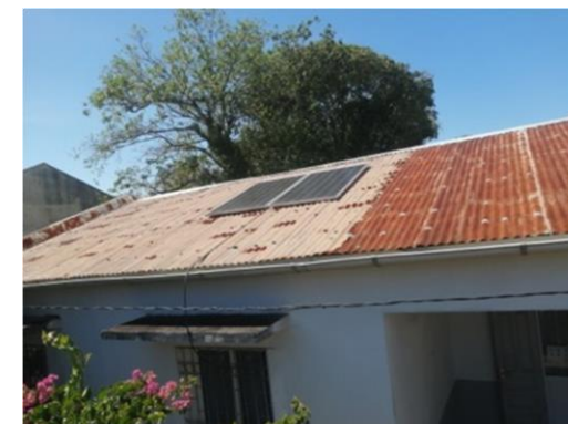
CHRD Vatomandry – Petite installation solaire pour le laboratoire
